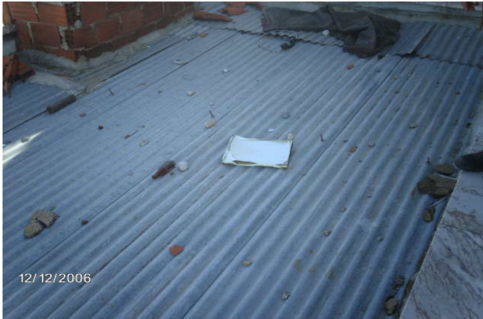
Obra ilegal – fecho do Logradouro
